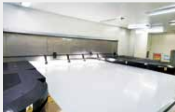
在山东滕州自主建设我国首条湿法锂电膜生产线
