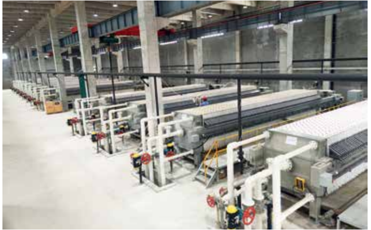
第二压滤车间情景
